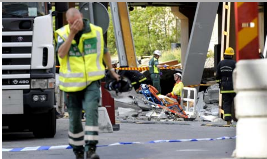
I juli 2008 inträffade ett ras på en byggarbetsplats i Kista väster om Stockholm där en montör avled.
